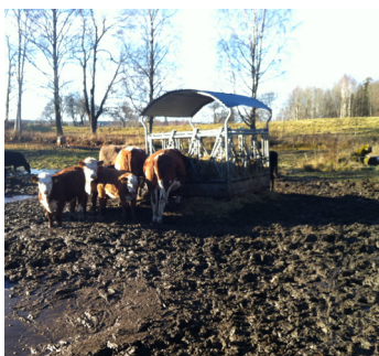
Marken kring utfodringsplatsen är inte förstärkt och har därför blivit förstörd av djurens tramp.
